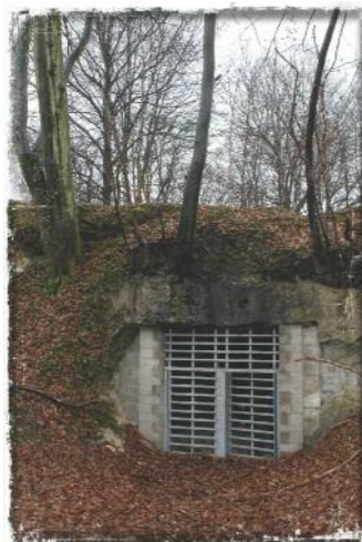
Fermeture d'une cavité souterraine pour la préservation des chauves-souris à Cessières (Aisne) (photo : R. François)
